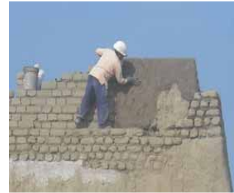
F- 03- Tarrajeo de muros a nivel de cabecera de muro en el paramento externo de la esquina sur oeste.
