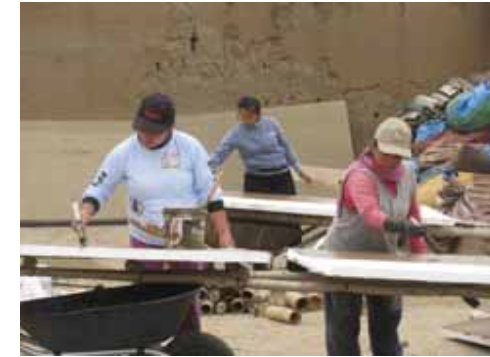
F- 05.- Trabajos de pintado y proteccion de las planchas de tecnoport destinadas a las cubiertas.
