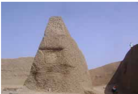
F- 01.- Presentacion final del muro perimetral norte - sector oeste, notese el acabado con la bruña que define las juntas de los adobones del tapial.
